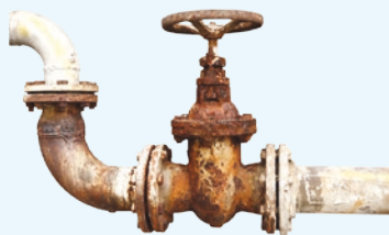
Figura 4.40 Cuando una tubería se daña por la oxidación ocasiona serias pérdidas económicas, pues pueden provocarse fugas de gas, agua potable o aguas residuales, entre otras.
